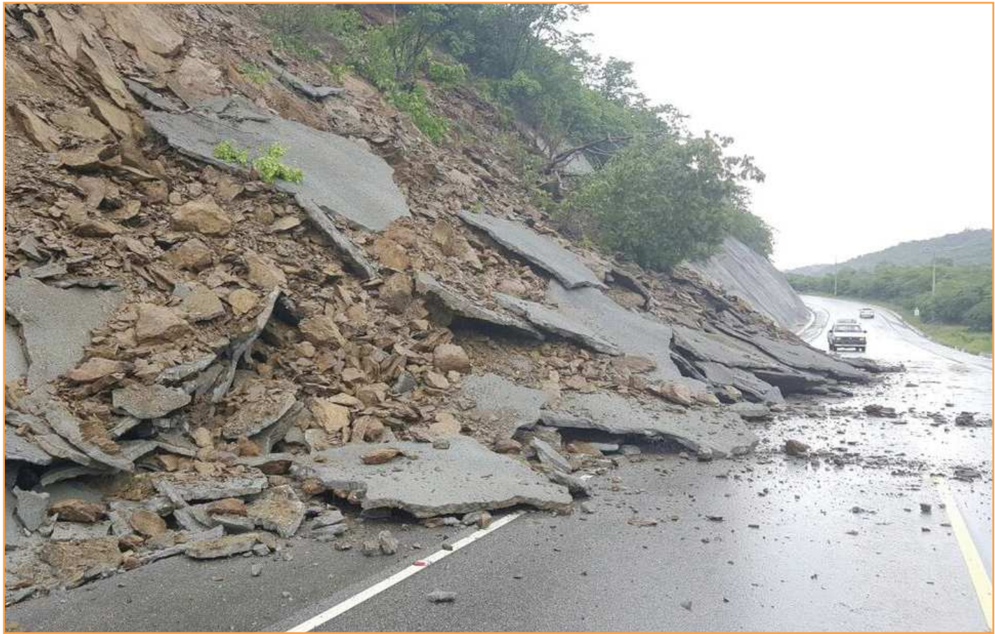
Deslizamiento de carretera. construcción en laderas sin protección.
