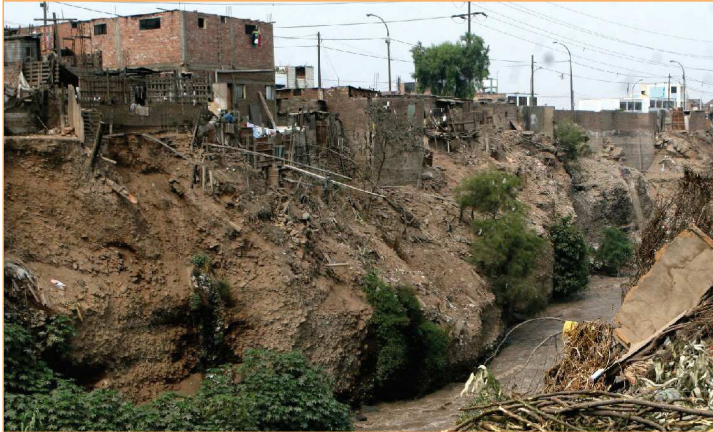
Construcciones en lugares vulnerables. Riesgo inminente..
