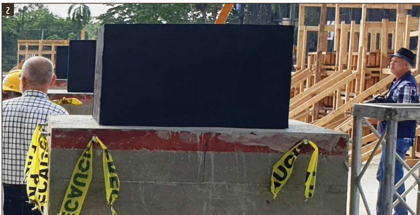
Imagen 2. Vista de uno de los aisladores sísmicos ya instalados en el nuevo hospital de San Fco de Macorís.
